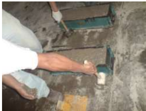
Figura . Expulsión del aire en el concreto.
