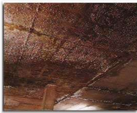
Figura 10. Estructura deteriorada por la Acción del congelamiento y deshielo.
