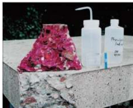
Fig . Determinación de la profundidad de carbonatación a través del rociado de una solución de fenolftaleína sobre la superficie del concreto recién roto [PCA, Boletín de ingeniería EB201].
