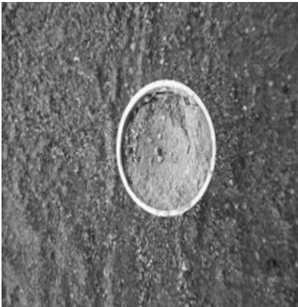
Perfil del fenómeno de socavacion.
