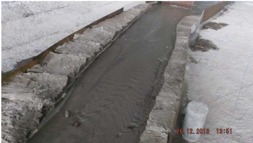
Figura 5.18 Deformación de los bordos entre las estaciones 0+560 a 0+300.
