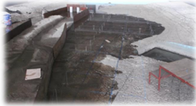
Figura 4.12 Infiltración del agua por las paredes del río.
