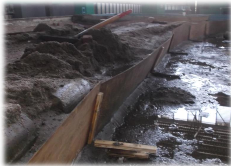
Figura 5.10 Muros deformados por la acción del flujo.
