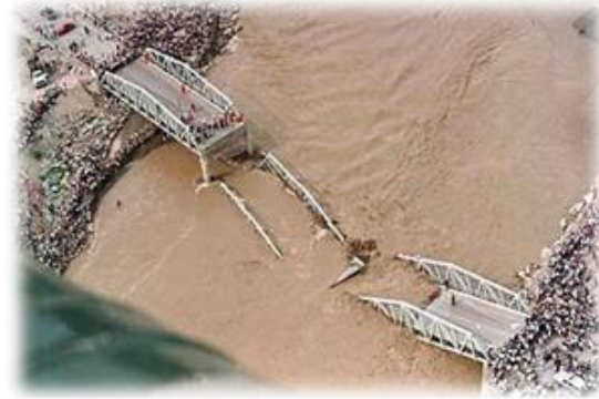
Figura 1.2 Colapso del puente Reque, Perú.
