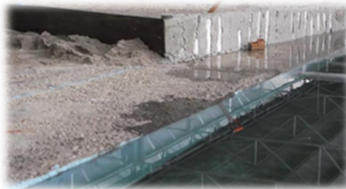
Figura 4.11 Infiltración del agua en cilindros sin aplanar.
