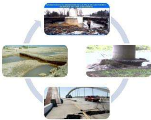
Figura 1.1 Daños estructurales en los puentes.
