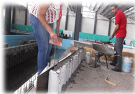
Figura 4.9 Colocación del refuerzo a los cilindros de concreto con mezcla de arena y cemento.
