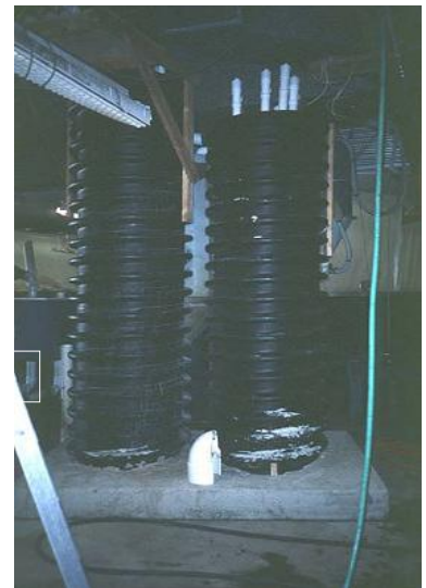
Figura 13. Filtro de arena
