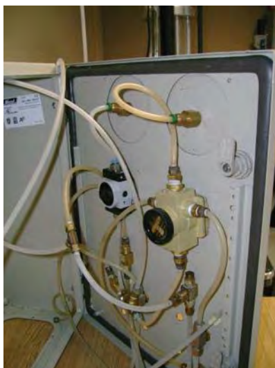
Imagen 3. 32 Panel de control (vista interna).
