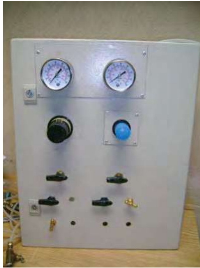
Imagen 3. 31 Panel de control (vista frontal).
