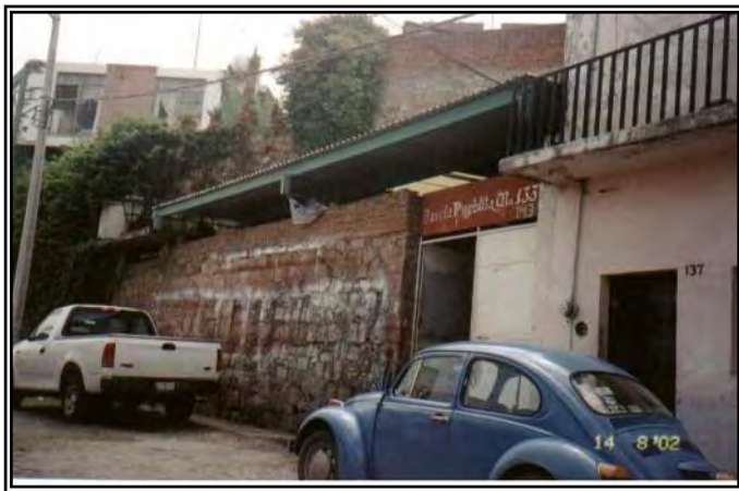
Imagen No 22 esta imagen es de la misma calle de García Pueblita, en donde se presentan los deterioros en los acabados y sobre todo el deterioro en el aspecto arquitectónico de los inmuebles.
