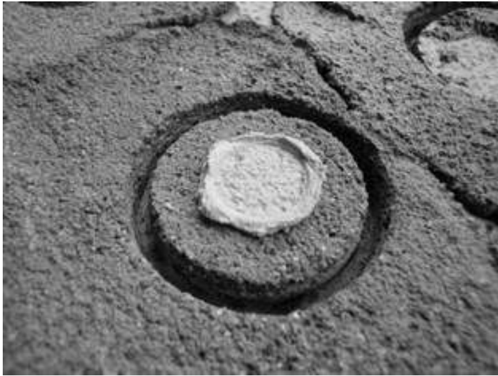
Ilustración 3.6.2.4.8. Falla entre epóxico y el disco metálico.
