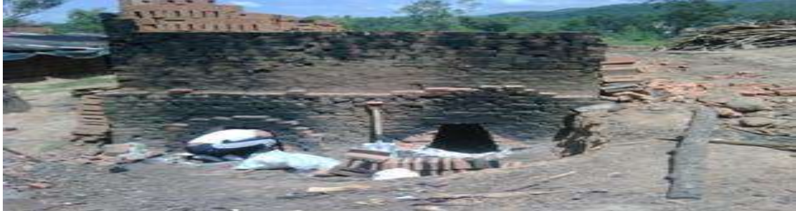
Ilustración 2.6.3.4. Extracción de la ceniza del horno de cocción del ladrillo, utilizando palas.
