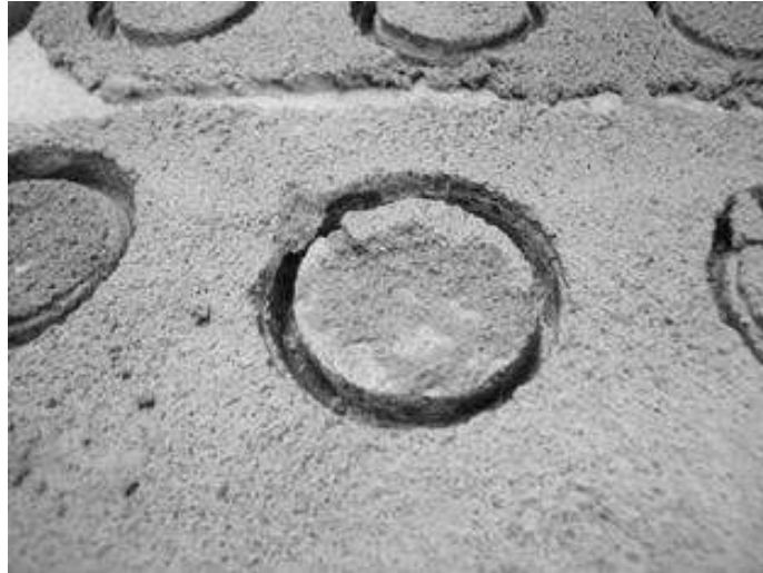
Ilustración 3.6.2.4.10. Falla en el revestimiento. Tipo 4.
