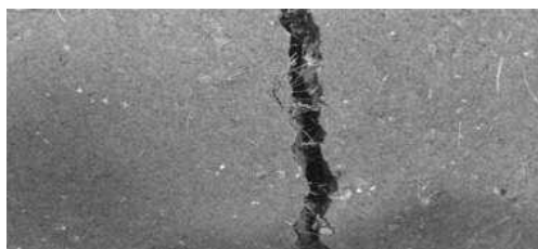
Fig. 43. Mostafa (2016). Fibras de plátano uniendo la grieta. Disponible en: https://www.sciencedirect.com/science/article/ . Consultada en junio de 2020.
