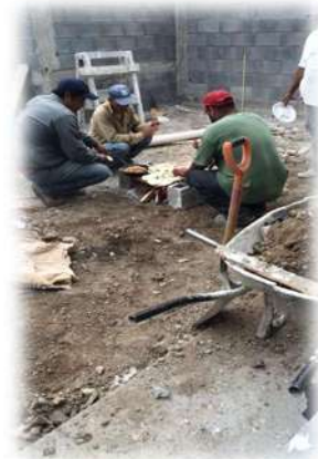
Figura 27 Problemas por Comer en la Obra. Recuperado de Riesgos-químicos-Spanish-FERNANDO-
