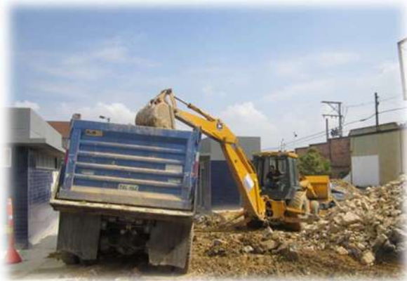
Figura 21 Uso de Retroexcavadora para Remoción de Escombros. Arispón y Vila (2006). Recuperado de https://www.mc-mutual.com
