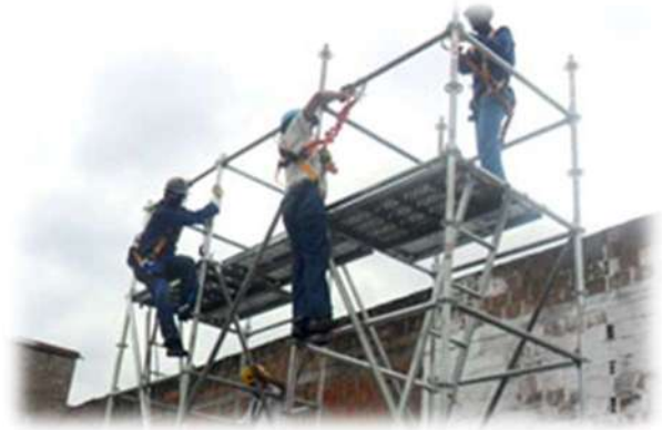
Figura 16 Riesgo en Andamios. Arispón y Vila (2006). Recuperado de https://www.mc-mutual.com
