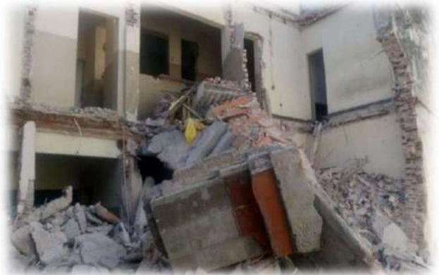
Figura 20 Riesgos en Remoción de Escombros. Arispón y Vila (2006). Recuperado de https://www.mc-mutual.com
