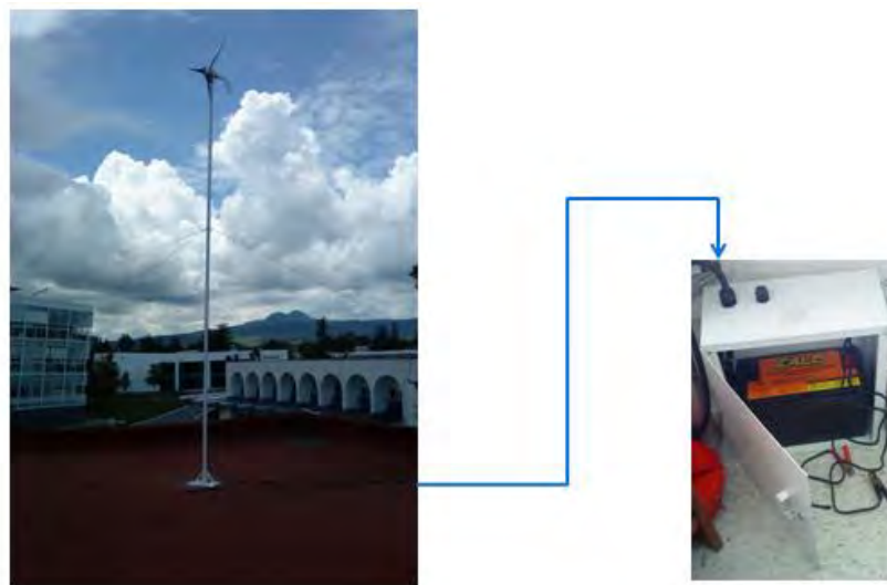
Figura 2.4 Aerogenerador instalado en edificio W
