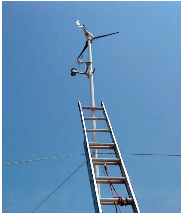
Figura 2.6 Instalación de la planta meteorológica
