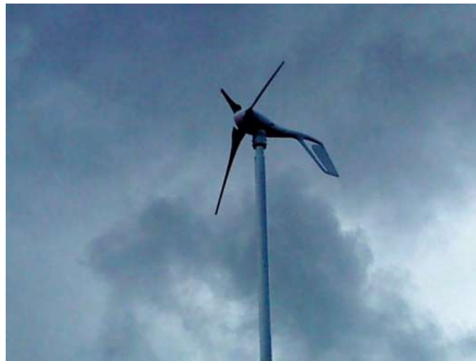
Figura 2.3 Aerogenerador instalado en edificio W
