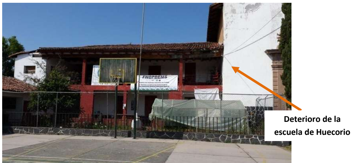
Imagen 9. Vista externa de la escuela donde se aprecia el deterioro del edificio que además se encuentra dentro del padrón del INAH. Fuente: Elaboración propia
