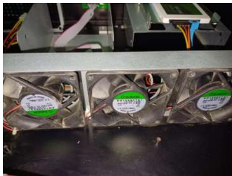
Figura 26: Ventiladores del nodo 1. El ventilador central tiene menos RPM que los dos en los extremos.
