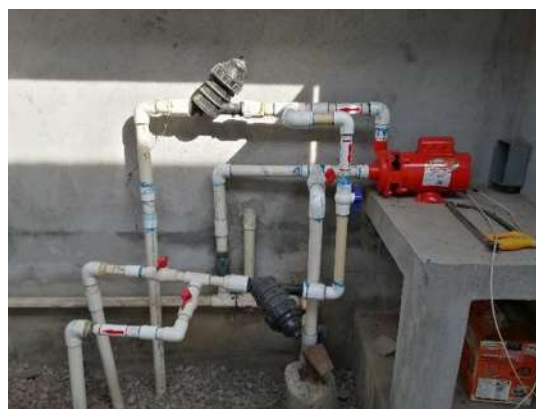
Figura 3.10 Bomba del sistema de riego.
