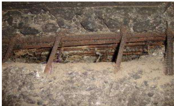
Figura 3.10 Exposición de estribos y acero de refuerzo en nervaduras.
