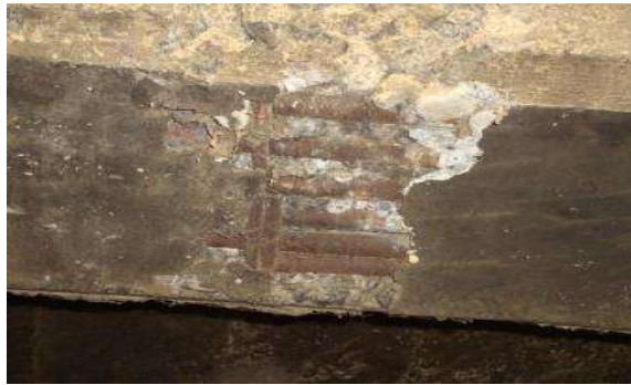
Figura 3.9 Despillamiento de nervadura y exposición del acero de refuerzo.
