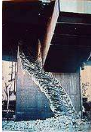
Figura 3.3 Falla por cortante en pila, durante el sismo de 1995 en Kobe, Japón (fuente: http://mceer.buffalo.edu/research/Reconnaissance/kobe1-17-95/summary.asp ).
