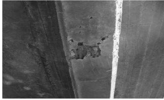
Figura 3.11 Exposición acero de refuerzo en nervaduras.
