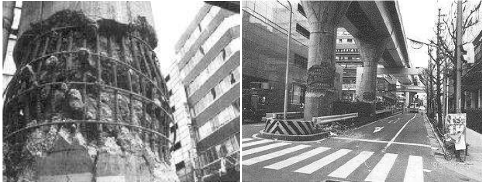
Figura 3.2 Detalle de pila dañada a flexión durante el sismo de 1995 en Kobe, Japón (fuente: http://mceer.buffalo.edu/research/Reconnaissance/kobe1-17-95/summary.asp ).
