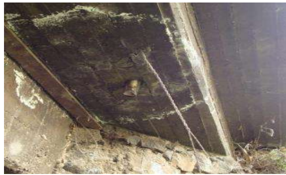
Figura 3.12 Humedad en losa en las proximidades del dren.
