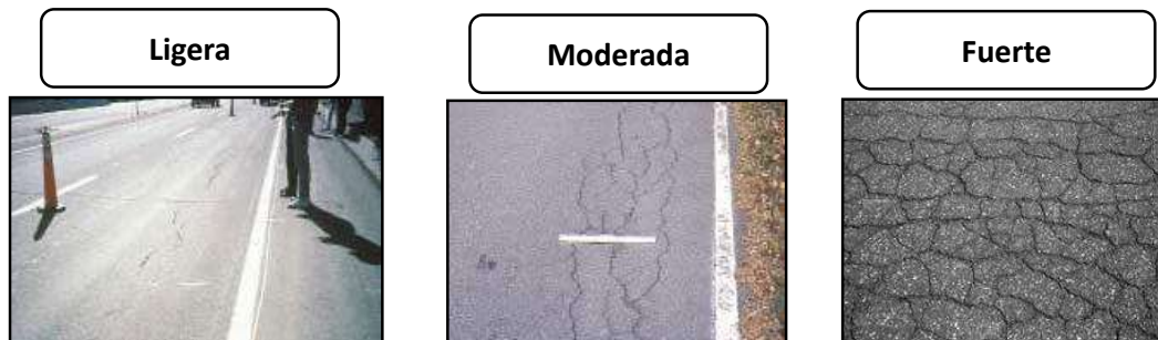
Figura 7 Progreso de la Fisuración por Fatiga.
