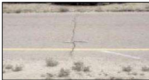
Figura 6 Agrietamiento por Baja Temperatura.
