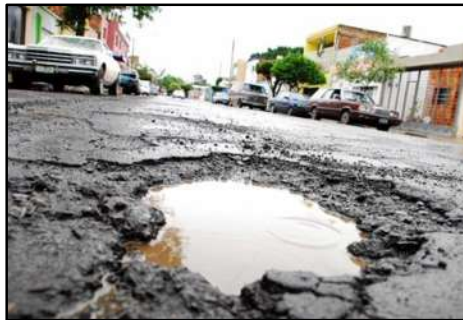
Figura 12 Desprendimiento de agregado, debido a la falta de adherencia agregado-asfalto.
