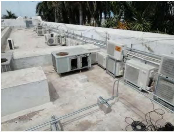
Figura 02. Compresores de aire acondicionado en azotea del edificio del Ayuntamiento de Culiacán.
