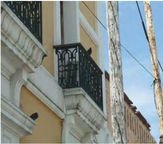
Figura 06. Compresor de aire acondicionado en balcón de fachada principal.
