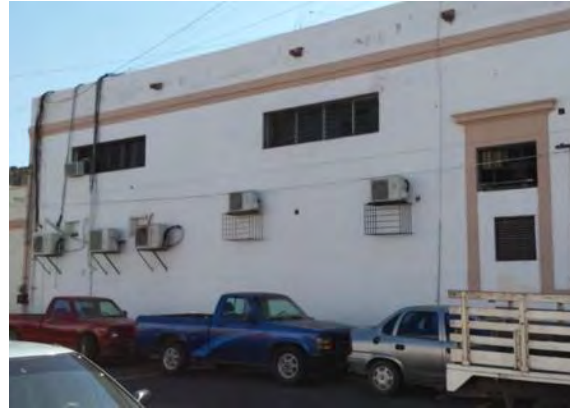
Figura 05. Compresores adosados a muro exterior del antiguo Edificio Central de la UAS.
