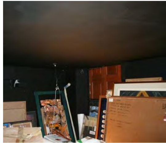
Figura 07. Altura de cubierta de falso plafón bloqueando puerta.
