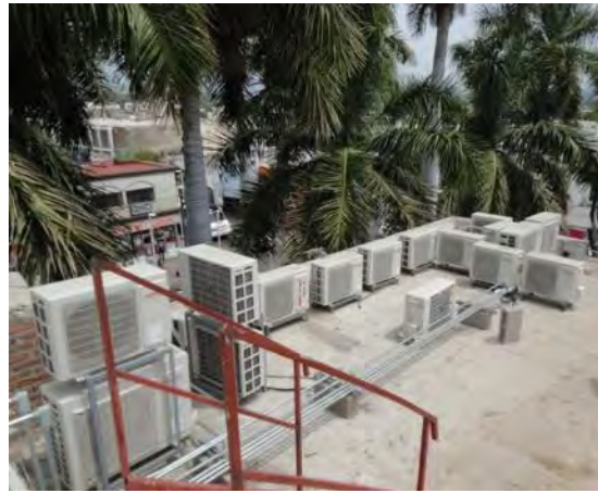
Figura 03. Compresores de aire acondicionado en azotea del edificio del Ayuntamiento de Culiacán.
