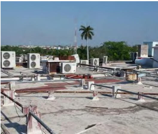
Figura 04. Compresores de aire acondicionado en azotea del edificio del antiguo Edificio Central de la UAS.
