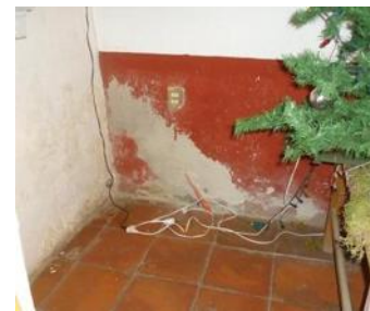
Figura 61. Vista de instalaciones eléctricas en el Presbiterio (esquina suroeste) - foto tomada en Marzo de 2012 por Anyul Cuéllar
