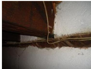
Figura 60. Vista de instalaciones eléctricas en el Coro - foto tomada en Marzo de 2012 por Anyul Cuéllar
