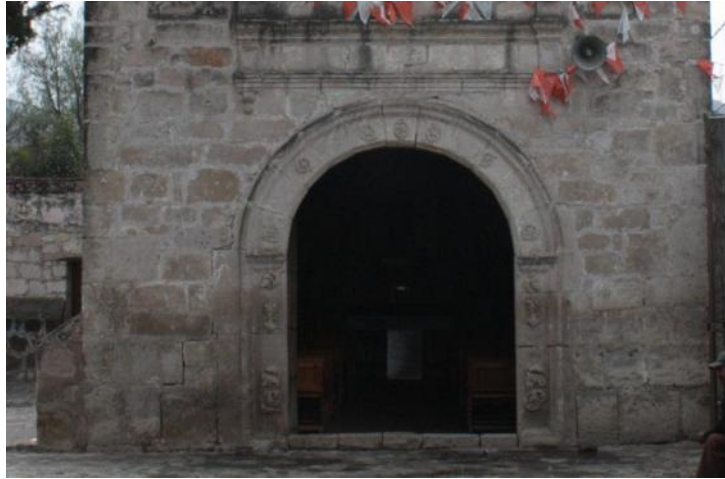
Figura 67. Manchas que revelan humedad ascensional, disgregación de sillares - foto tomada en Junio de 2012 por Hugo Pedraza
