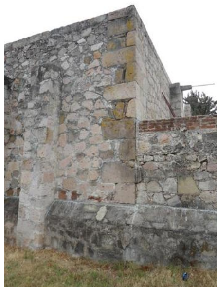
Figura 112. Diferencia de altura en volúmenes, fisura que inicia en la junta y sube hacia la izquierda- foto tomada en Marzo de 2012 por Deniss Castañeda
