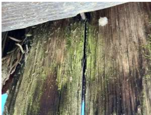
Imagen 48. Moho verde y musgo en tejamanil. 110
