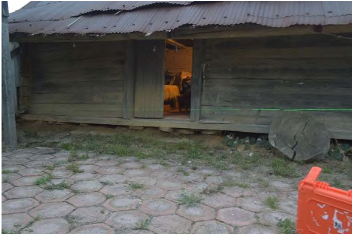
Imagen 63. Desnivel en la fachada sur del troje
