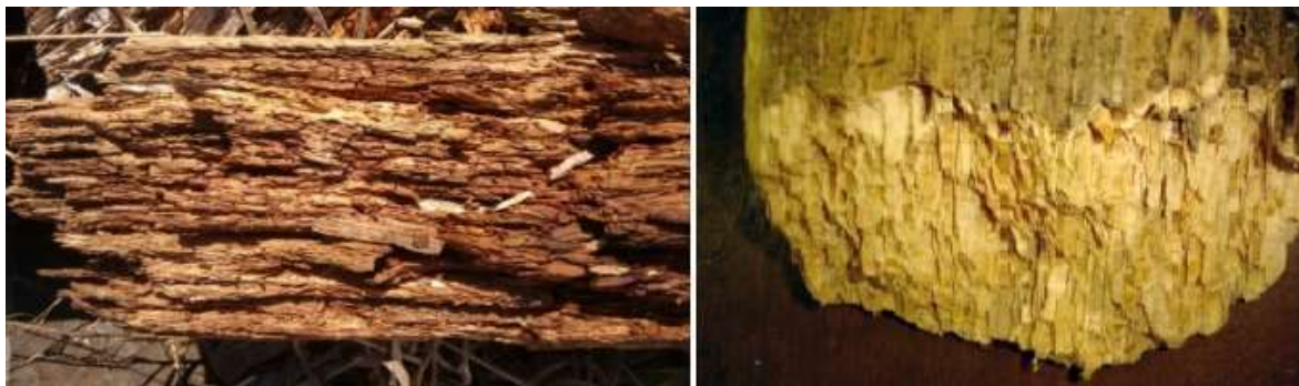
Imagen 45. Madera atacada por hongo de pudrición blanda, en estado avanzado de deterioro. 95
