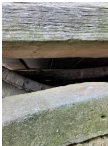
Imagen 47. Moho verde en viga durmiente. 99
