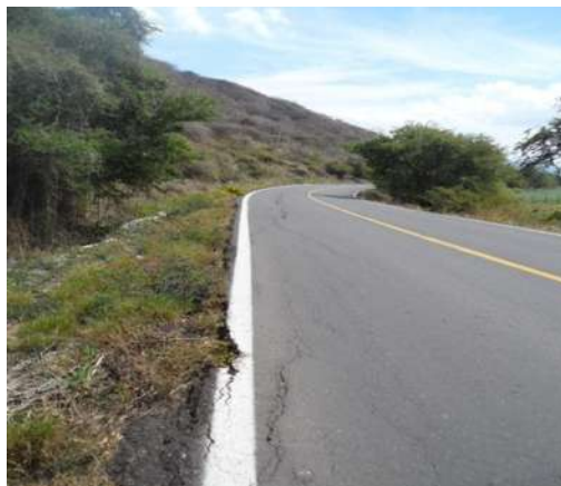
| Imagen 18. Presencia de Grietas Longitudinales Subtramo 2 Quiroga - Carapan Fuente: Elaboración Propia |
