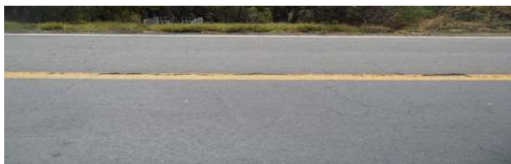
| Imagen 17. Presencia de Grietas y Desprendimiento de la última capa de Tratamiento Superficial Subtramo 1 Morelia - Quiroga Fuente: Elaboración Propia |
