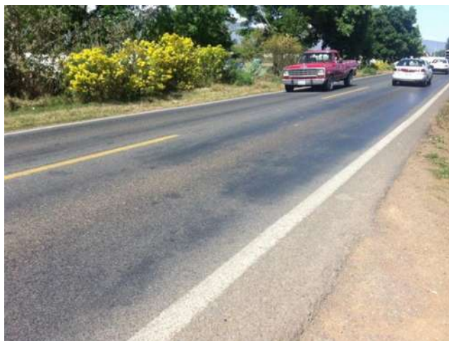
| Imagen 19. Presencia de Exudación Asfalto Subtramo 3 Carapan - Zamora Fuente: Elaboración Propia |
