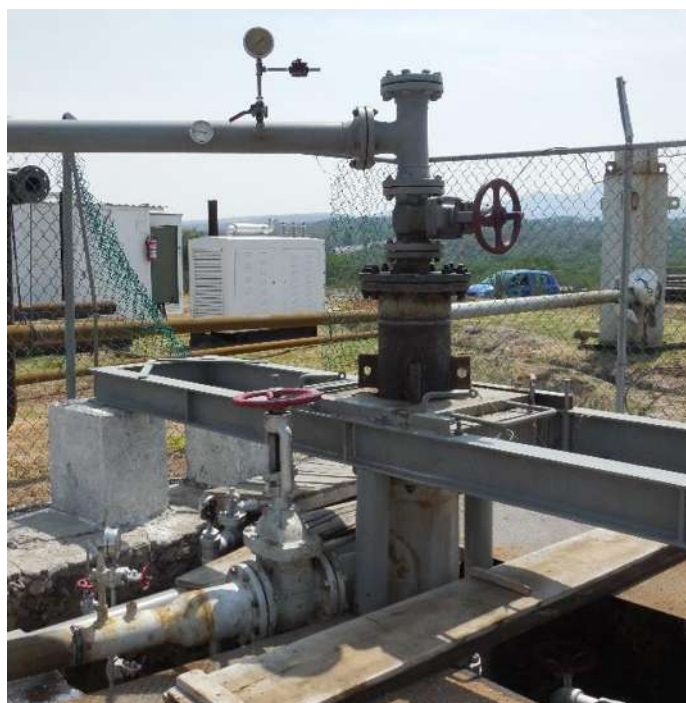
Figura 4.9. Acabado final del cabezal de válvulas conectado con el circuito de tuberías de recirculación.
