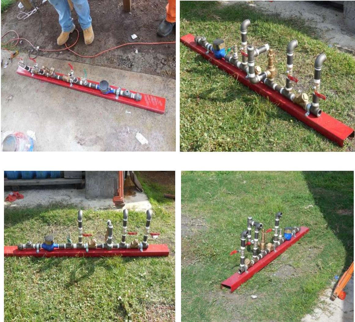
Figura 4.18. Tren de válvulas e instrumentos anclados en base.
