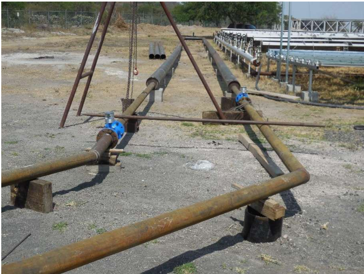
Figura 4.6. Acabado final del circuito de tuberías de recirculación.
