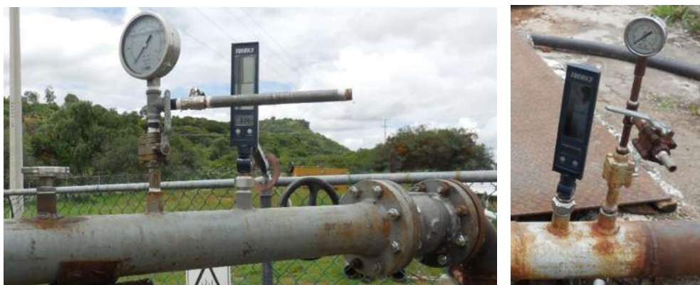
Figura 4.8. Instrumentos de medición a la salida y entrada del pozo geotérmico.
