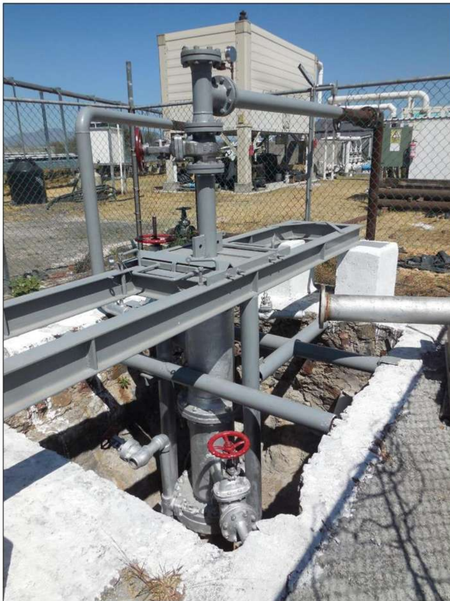
Fig. 1. Vista del pozo geotérmico Z-3.
