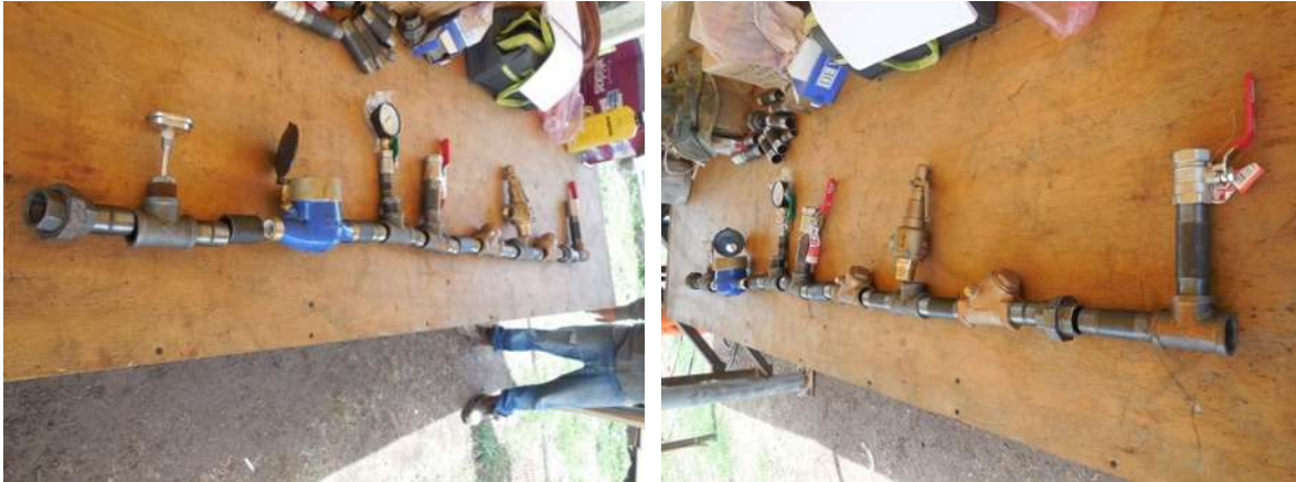
Figura 4.14. Presentación de elementos que componen al tren de válvulas e instrumentos.
