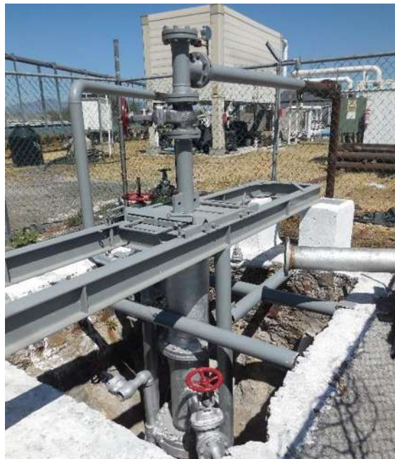
Figura 3.1. Cabezal del pozo geotérmico Z-3.
