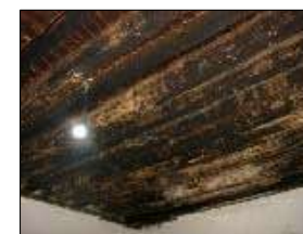
FOTO 02: CUARTO 2 VISTA PARCIAL DE ALTERACIONES DE METAL ALACERADO
