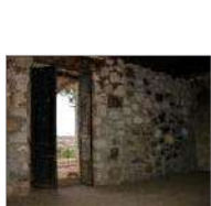
FOTO 12 / LOCAL 6 / VISTA VANO DE PUERTA AUTOPRODUCIBLE, FOTOGRAFADO SANCHEZ FECHA DEL 2017
