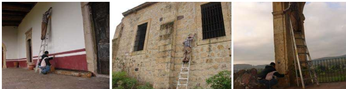
Ilustración 81, Imágenes del levantamiento de grietas y desplomos. Autor: Gabriel Mercado Sánchez, Junio 2014
