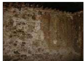
FOTO 04: LOCAL 1 VISTA PARCIAL DE DETERIORO EN APOYOS CORRIDOS Y MUROS. AUTOPRUEBA: MARCELO SANCHEZ. FEBRERO DE 2015.
