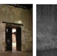
FOTO 17 / LOCAL 11 / VISTA VANO DE PUERTA AUTOPRODUCIBLE, FOTOGRAFADO SANCHEZ FECHA DEL 2017
