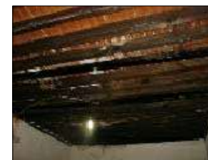
FOTO 02: LOCAL 4 (VISTA PARCIAL) DE DETERIORO EN TECHOS AUTOR: ANDRÉS MARCELO GARCIA FECHA: 08/06/15
