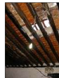
FOTO 03: LOCAL 4 VISTA PARCIAL DE ALTERACIONES DE METAL ALACERADO
