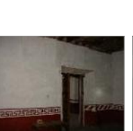
FOTO 14 / LOCAL 8 / VISTA VANO DE PUERTA AUTOPRODUCIBLE, FOTOGRAFADO SANCHEZ FECHA DEL 2017
