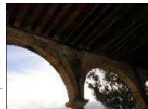
FOTO 03: PUERTA Y VISTA PARCIAL DE DETERIORO EN APOYOS CORRIDOS. AUTOPRUEBA: MARCELO SANCHEZ. FEBRERO DE 2015.
