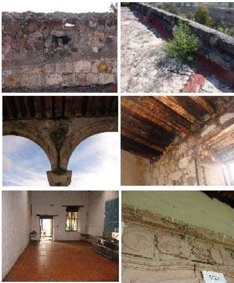
Ilustración 74, Ejemplos de agentes y causas del deterioro en el edificio, Autor. Gabriel Mercado. Diciembre 2013
