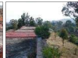
FOTO DE AZOTEA / VISTA PARCIAL DE DETERIORO EN CUBIERTAS ACTUACIONES: REPARACION DAÑADOS FECHA: 08/05/2015
