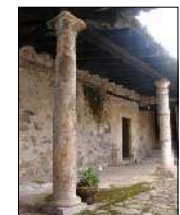
FOTO 02: PARED RESERVOIR VISTA PARCIAL DE DETERIORO EN APOYOS CORRIDOS Y MUROS. AUTOPRUEBA: MARCELO SANCHEZ. FEBRERO DE 2015.
