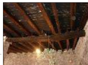
FOTO 03: SALON (VISTA PARCIAL) DE ALTERACION EN TECHOS AUTOR: ANDRÉS MARCELO GARCIA FECHA: 08/06/15
