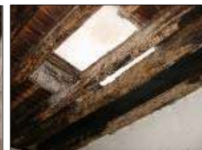
FOTO 04: LOCAL 2 (VISTA PARCIAL) DE DETERIORO EN TECHOS AUTOR: ANDRÉS MARCELO GARCIA FECHA: 08/06/15
