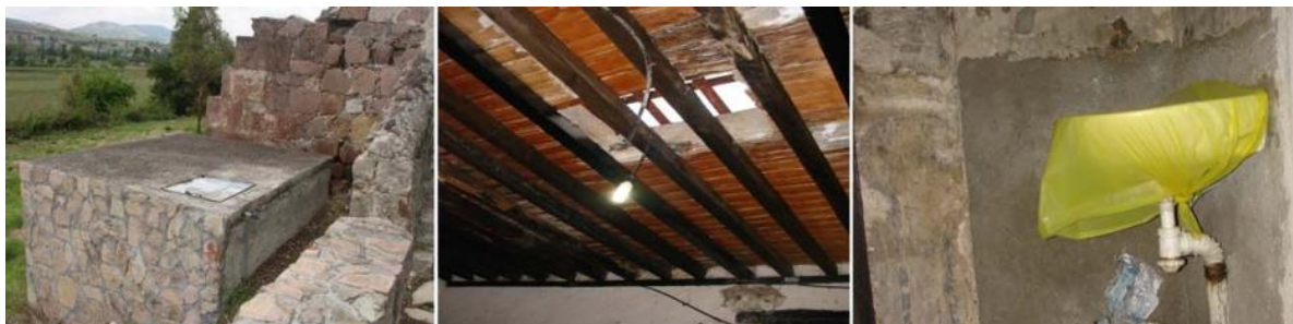
Ilustración 72, Imagen de parte de las instalaciones hidráulica, eléctrica y sanitaria en el inmueble. Autor: Gabriel Mercado Sánchez, Diciembre 2013
