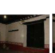
FOTO 15 / LOCAL 9 / VISTA VANO DE PUERTA AUTOPRODUCIBLE, FOTOGRAFADO SANCHEZ FECHA DEL 2017
