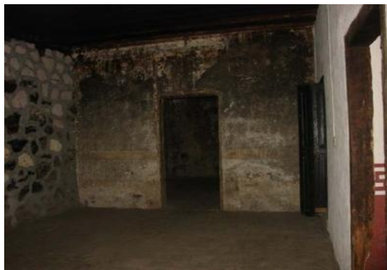
Ilustración 49 Deterioro en acabados por incendio Autor: Gabriel Mercado Sánchez, Diciembre 2013
