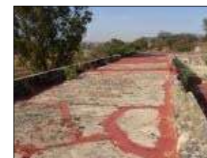
FOTO DE AZOTEA / VISTA PARCIAL DE DETERIORO EN CUBIERTAS ACTUACIONES: REPARACION DAÑADOS FECHA: 08/05/2015
