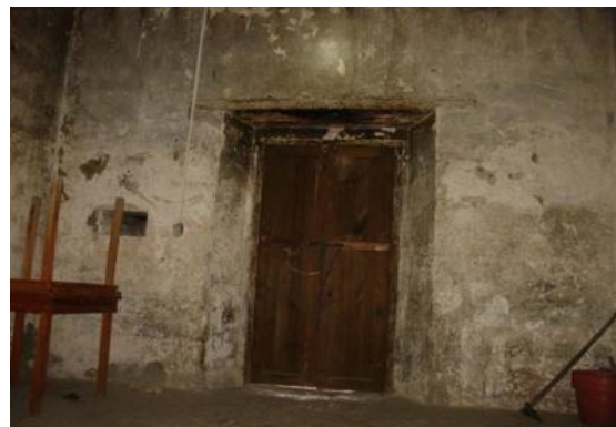
Ilustración 50 Deterioro en acabados por incendio Autor: Gabriel Mercado Sánchez, Diciembre 2013
