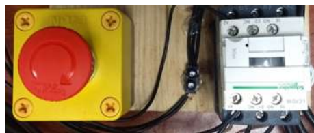
Figura 5.50: Interruptor trifásico conectado a un boton de paro de emergencia.
