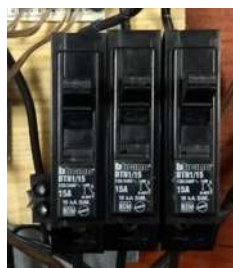
Figura 5.51: Interruptor termomagnético colocado en el filtro LCL lado fuente.
