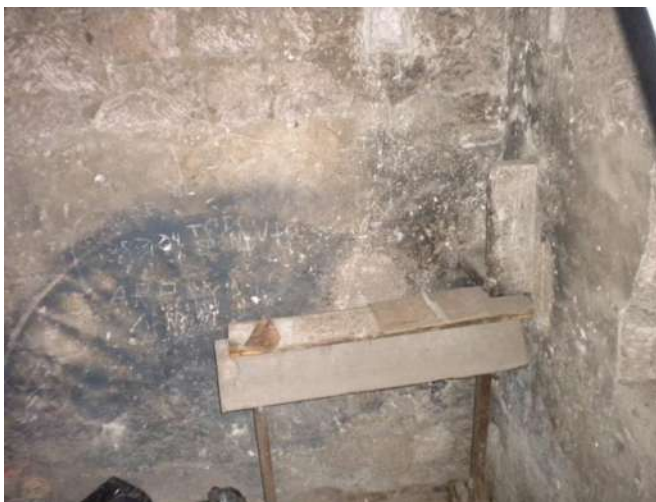
Ilustración 42. Estado actual de conservación Templo de San Agustín, interior de la torre mayor del campanario, Morelia 2014
