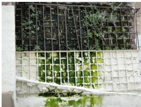
Ilustración 47. Estado actual de conservación del convento Santa María de Gracia, Morelia 2014
