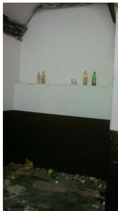
Ilustración 48. Estado actual de conservación del convento Santa María de Gracia, Morelia 2014
