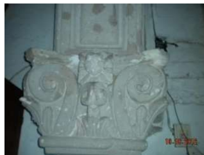
Ilustración 35. Estado actual de conservación del Templo San Agustín, Morelia
