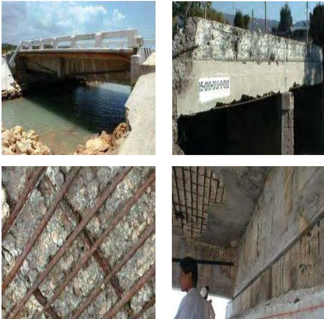
Figura 2.24. Deterioros encontrados en puentes causados por efecto de la corrosión y otras patologías.
