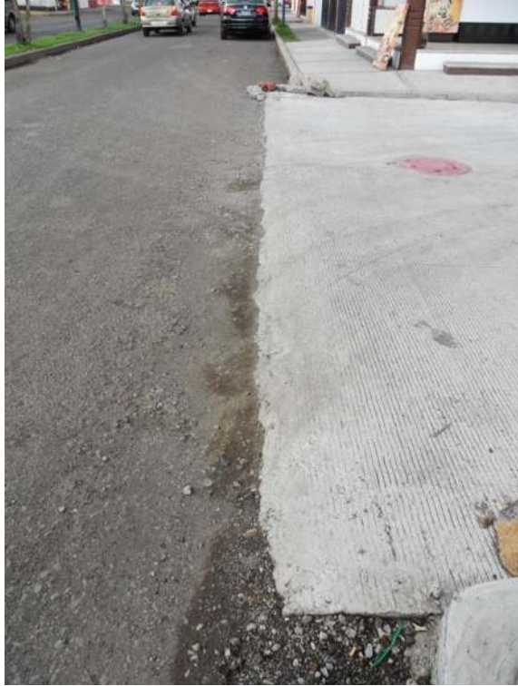
Fotografía No. 13: Juntas defectuosas; fuente Propia
