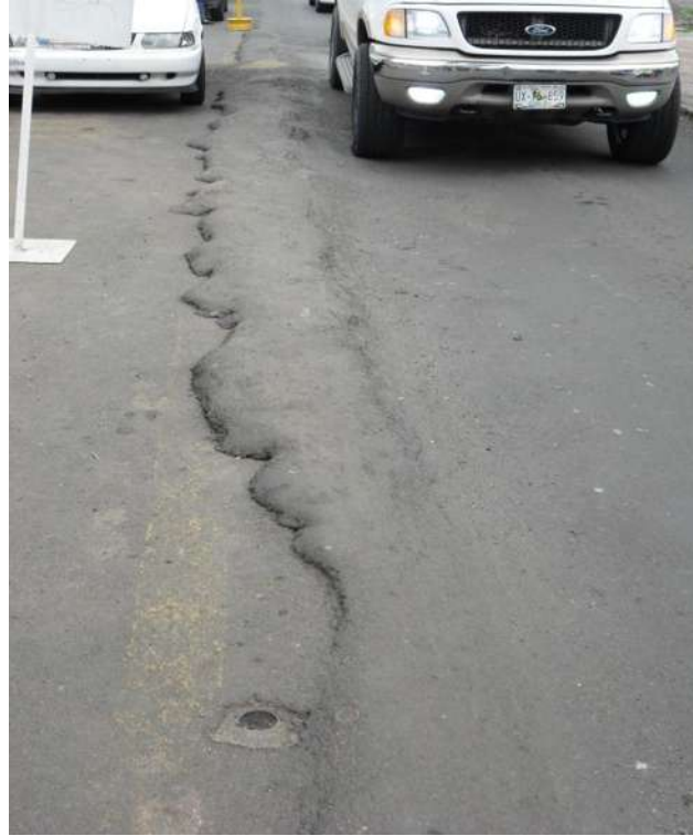
Fotografía No. 7: engrosamiento; fuente Propia
