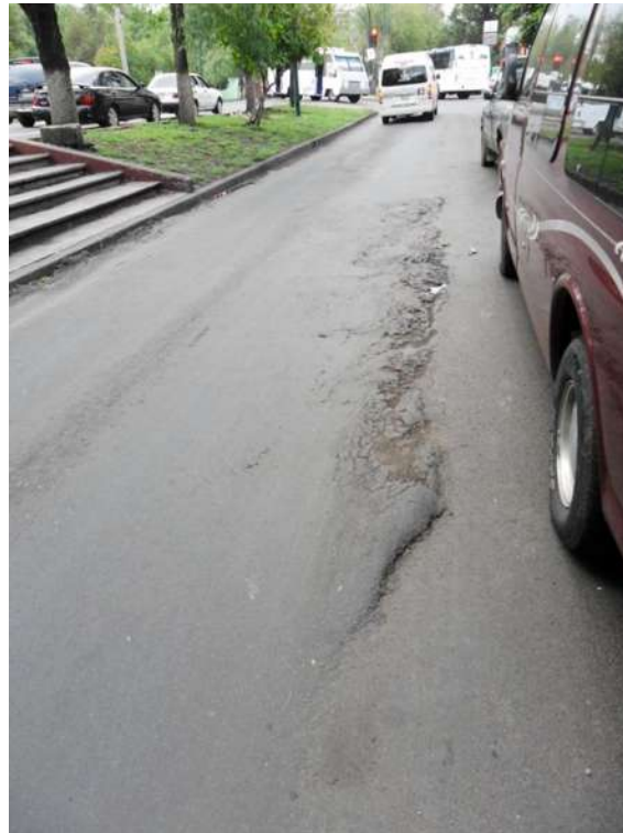
Fotografía No. 1: hundimiento del pavimento; fuente Propia
