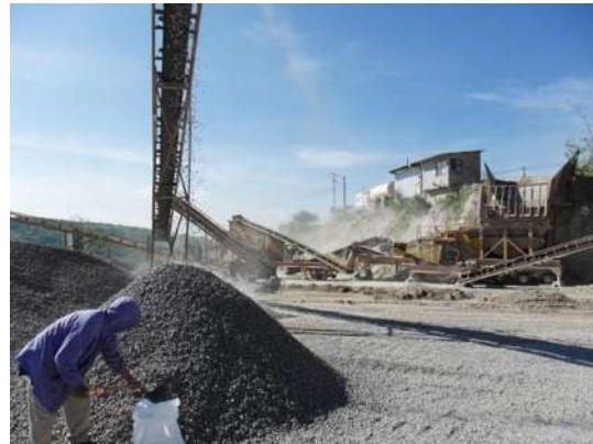
Fotografía No. 28: obtención del material directamente del depósito de la banda transportadora; fuente propia
