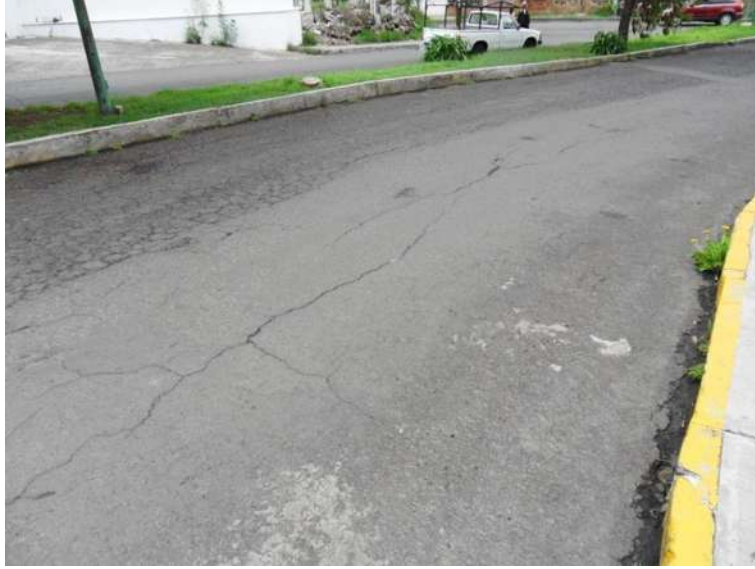
Fotografía No. 9: grietas longitudinales; fuente Propia
