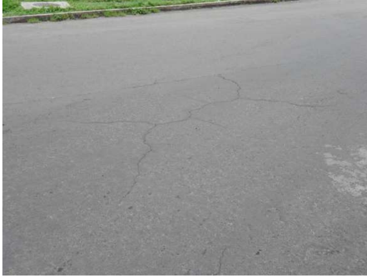
Fotografía No. 11: agrietamiento; fuente Propia
