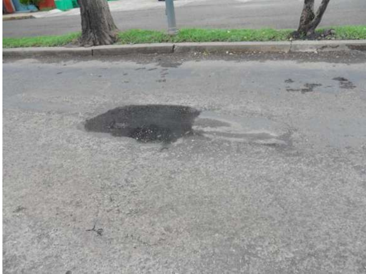
Fotografía No.6: desprendimiento; fuente Propia
