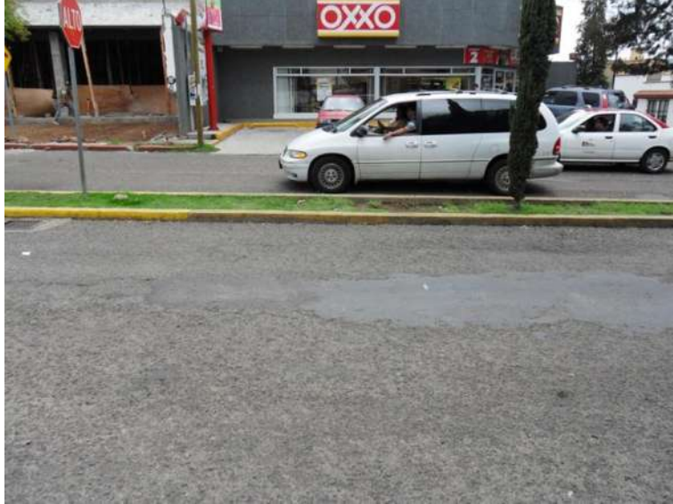
Fotografía No. 5: Descamado; fuente Propia
