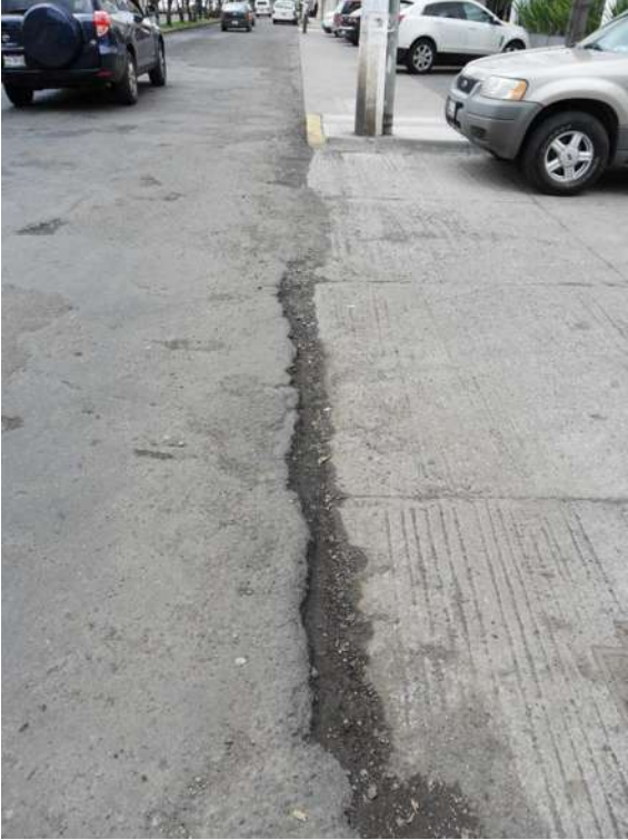
Fotografía No. 12: juntas defectuosas; fuente Propia
