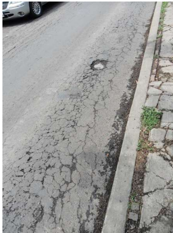
Fotografía No. 2: Hundimiento de bordes fracturados; fuente Propia
