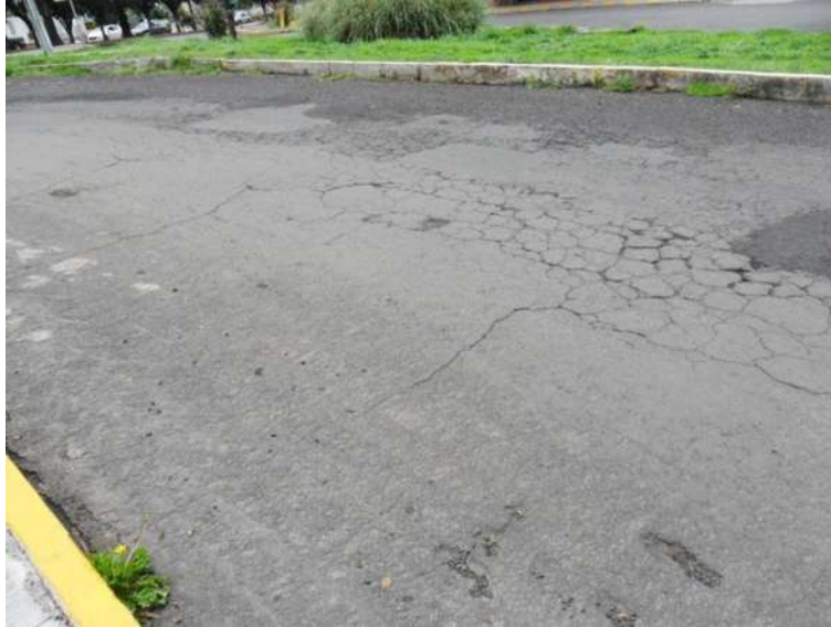
Fotografía No.10: grietas transversales, fuente Propia
