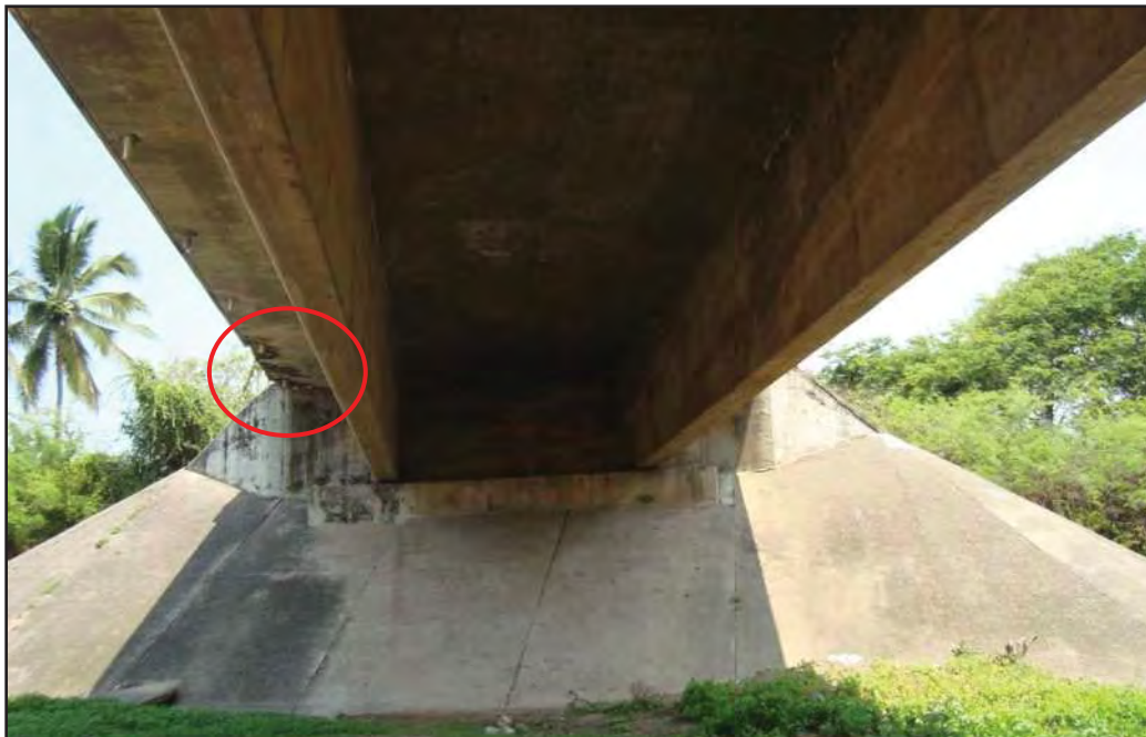
Foto VIII.3.- Estribo Izquierdo Cara Oeste Inferior (03/JUN/2011).
