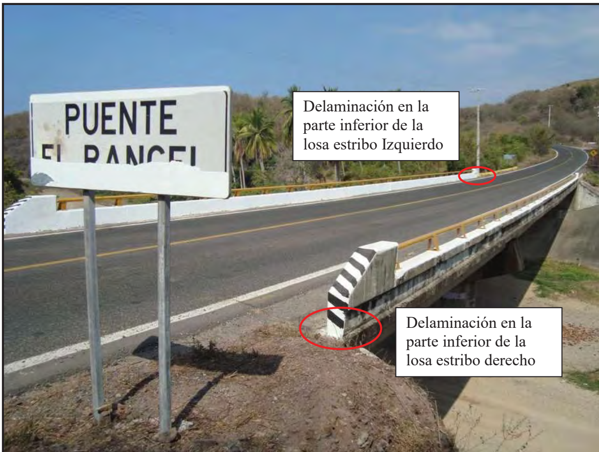
Foto X.3 Zonas de delaminación del Puente “El Rangel” Vista Este - Oeste (31/MAR/2011).
