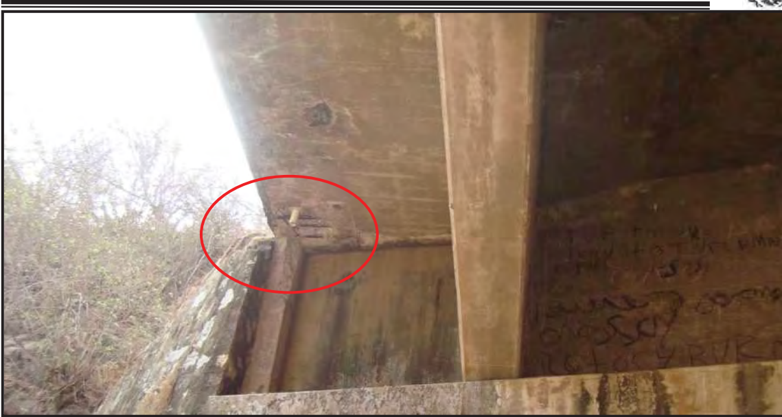
Foto X.1 Puente “El Rangel” Vista inferior Estribo derecho cara Este (31/MAR/2011).
