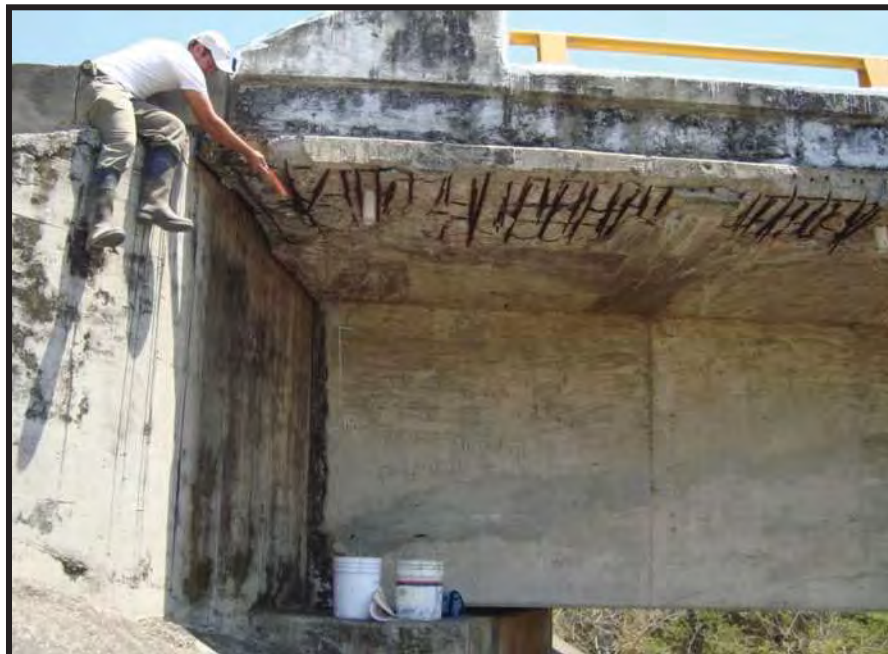
Foto V.1 Losa del puente “El Rangel” en Lázaro Cárdenas, Michoacán se muestra que el elemento probablemente ya rebaso su vida útil (30/MAR/2011).
