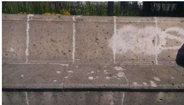
Figura 75.- Mobiliario con deterioro por químico de pintura en aerosol. Imagen tomada por Gabriel Cortés Mancera, [10/01/19].
