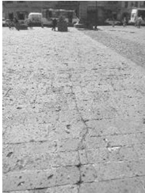
Figura 74.- Agrietamiento en acceso a ex -convento de iglesia. Imagen tomada por Gabriel Cortés Mancera, [10/01/19].
