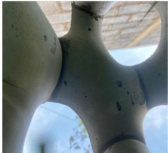
Figura 93: Pliegues en cimbra de Vinipiel afectada por peso del concreto fresco, elaboración propia.
