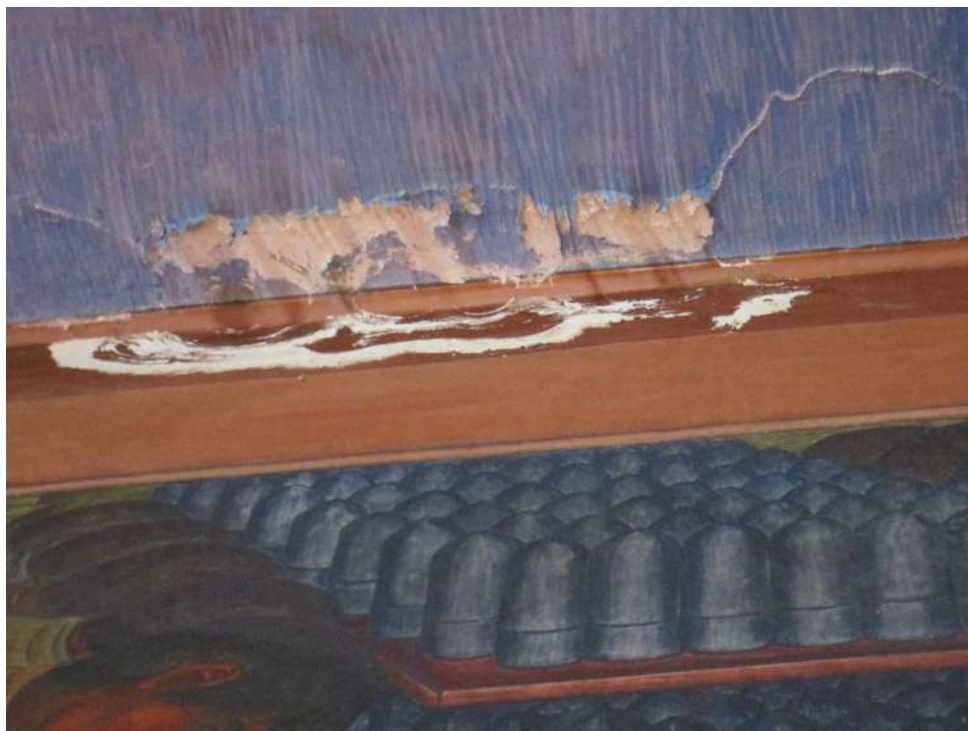
Imagen 35: Deterioro del muro este de La minería . Tomada por la autora.
