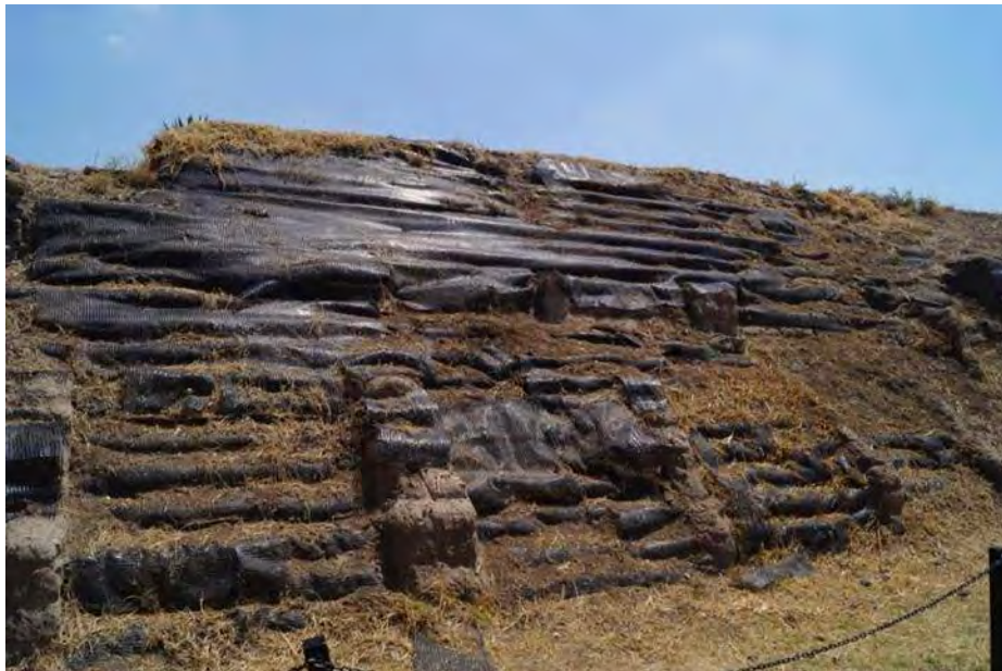
Imagen 119.- Núcleos de adobe expuestos en edificios anexos a la Pirámide del Sol, lado sur, se destaca la fragilidad de los materiales y el problema de conservación que implica proteger con plástico este tipo de material, a partir del daño que genera la formación de microclimas.
