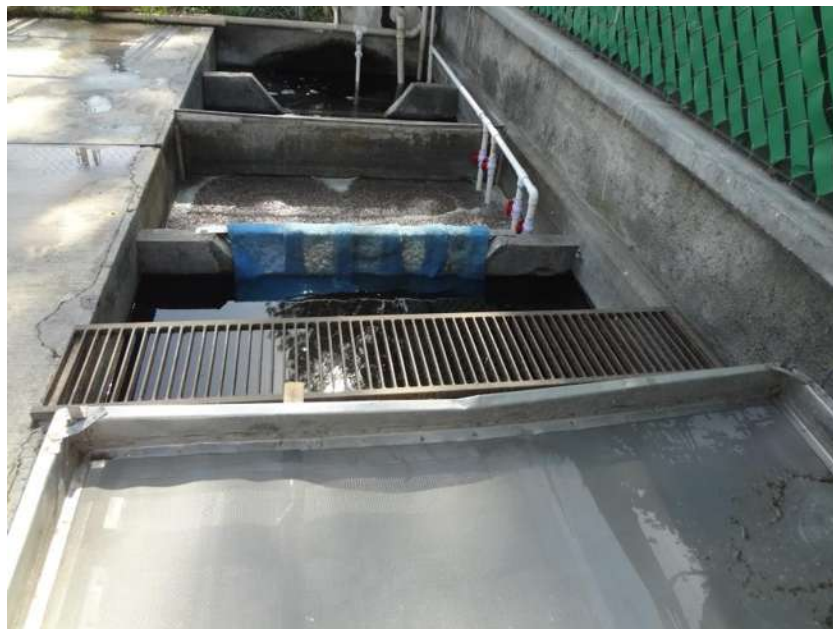
Figura 3.5 Fotografía del reactor en la que se aprecia el sistema de tratamiento.
