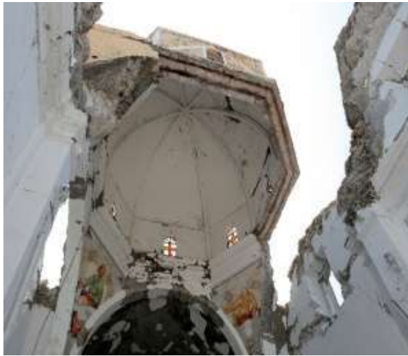
Fig. 34: Templo de Santiago Apóstol en Atzala Puebla, en ruinas después del sismo del año 2017.
