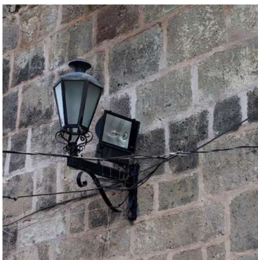
Fig. 116 Instalación eléctrica en la portada. Fotografía: ASS.
