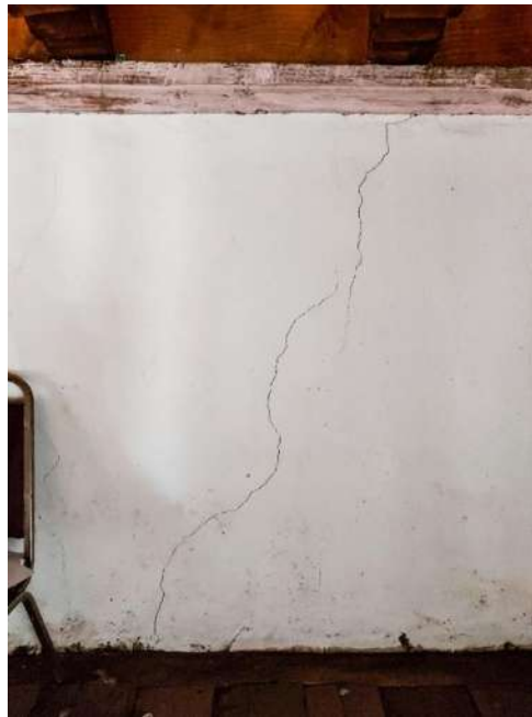
Fig. 139 Grietas en muro sur junto a la fachada. Fotografía: ASS.
