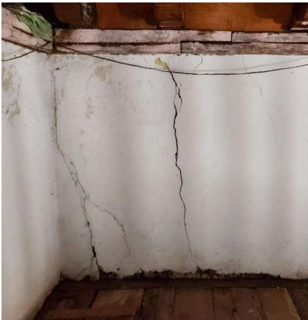
Fig. 138 Grietas en muro norte junto a la fachada. Fotografía: ASS.
