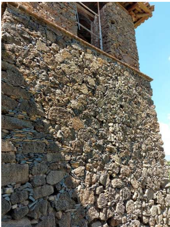
Fig. 136 Abultamiento en muro de la torre. Fotografía: ASS.
