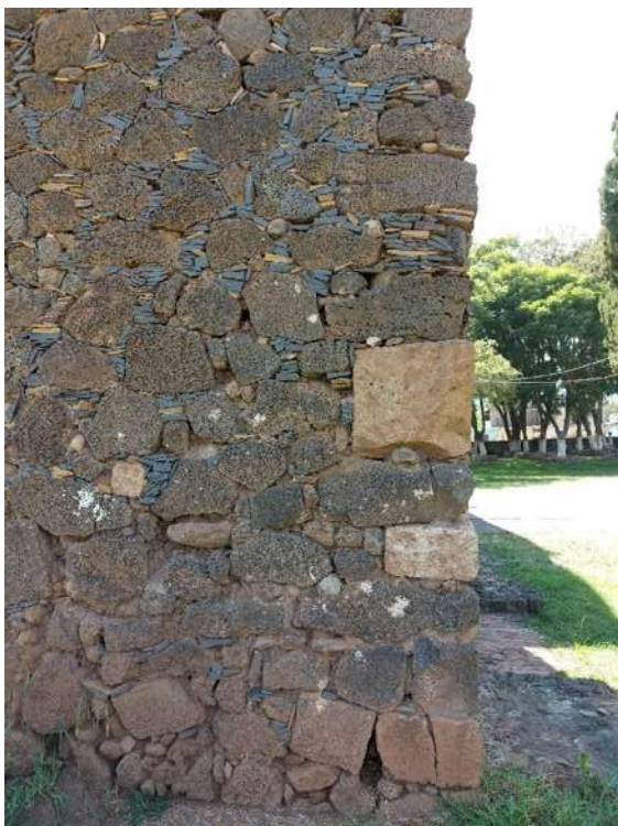
Fig. 103 Fracturas en cadena de ángulo de la torre. Fotografía: ASS.
