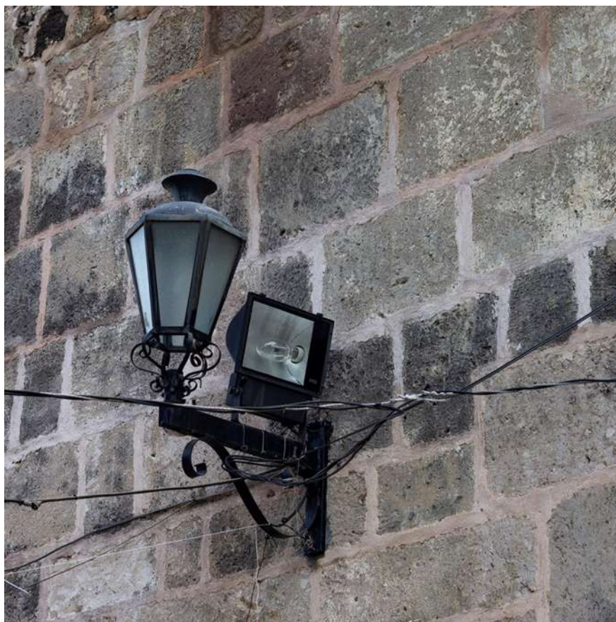
Fig. 51 Instalación eléctrica en portada del templo. Fotografía: ASS.
