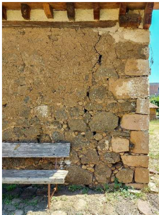
Fig. 104 Fractura en muro de la sacristía. Fotografía: ASS.
