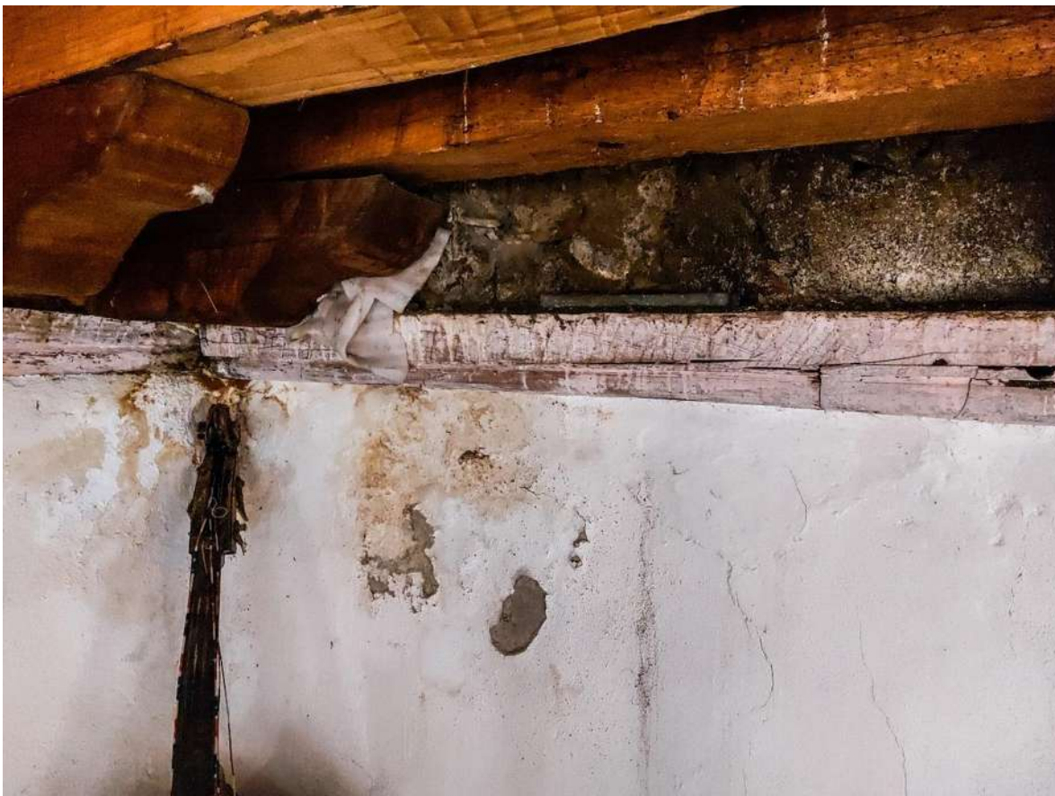
Fig. 99 Humedad presente en el coro. Fotografía: ASS.
