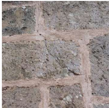
Fig. 102 Grieta en portada. Fotografía: ASS.
