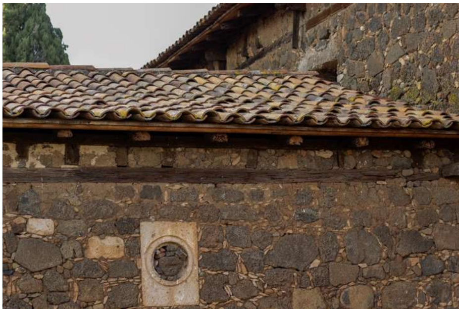
Fig. 114 Deflexión en la pendiente oriente de la cubierta de la sacristía. Fotografía: ASS.
