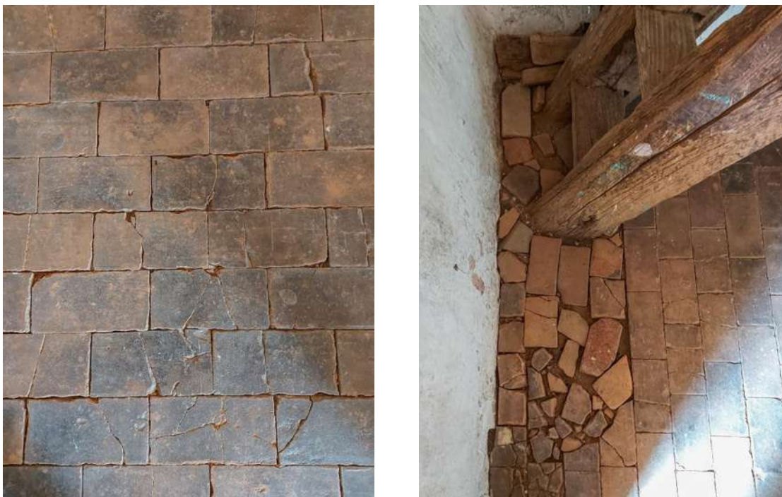
Fig. 111 Loseta de barro dañada y faltante. Fotografía: ASS.
