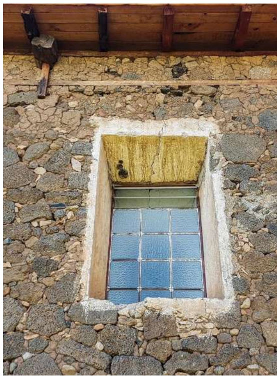
Fig. 137 Sistema constructivo erróneo en ventanas laterales. Fotografía: ASS.
