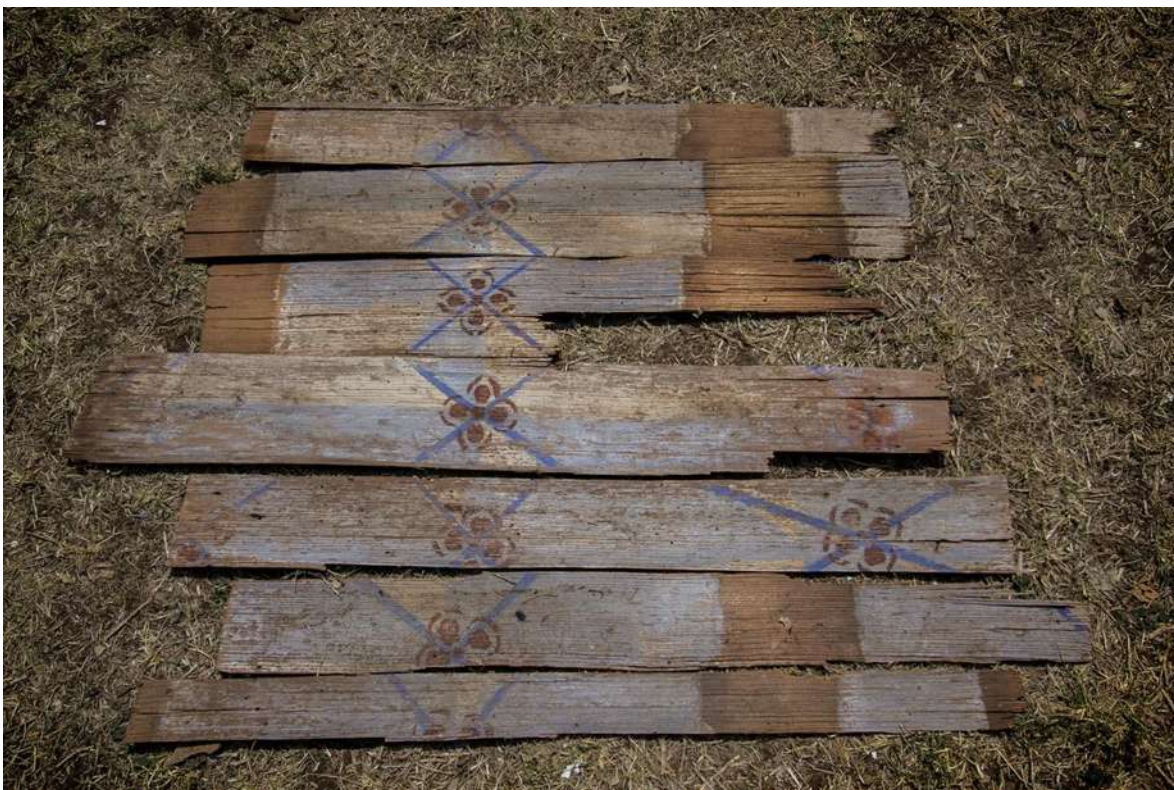
Fig. 112 Piezas de cielo raso que se retiraron. Fotografía: ASS.
