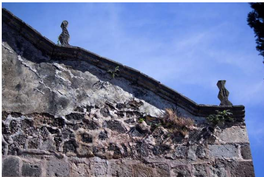
Fig. 115 Sección superior de la portada con desprendimiento de aplanado. Fotografía: ASS.
