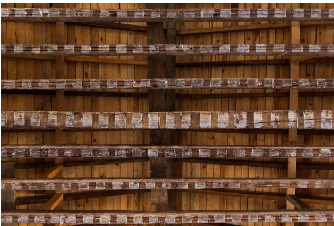
Fig. 128 Cubierta con la pérdida del tablón que iba sobre las vigas. Fotografía: ASS.
