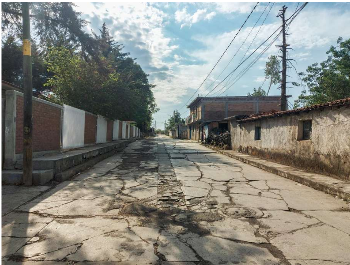
Fig. 16 Pavimentación en mal estado. Autoría: Adrián Solís.
