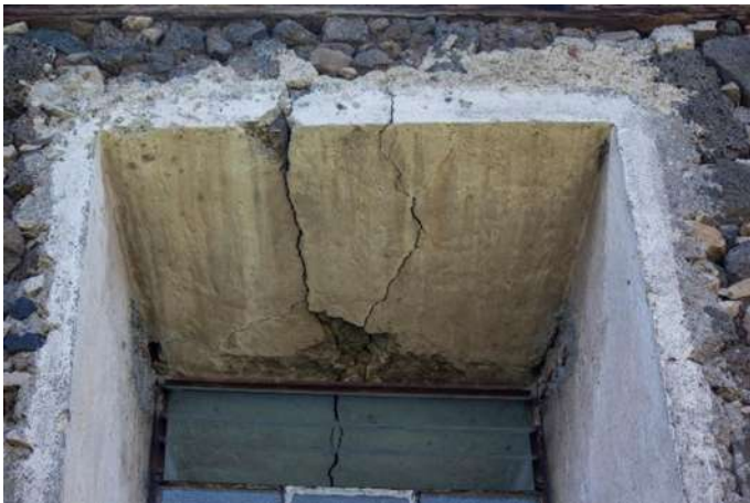
Fig. 101 Fractura en vano de la nave. Fotografía: ASS.
