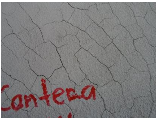
Figura 31. Agrietamiento con polvo de cantera
