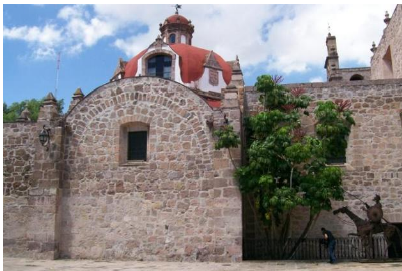
Figura 38. Pared del templo del Carmen en Morelia, se observa la necesidad de rejuntado entre los materiales pétreos. Foto MGDC
