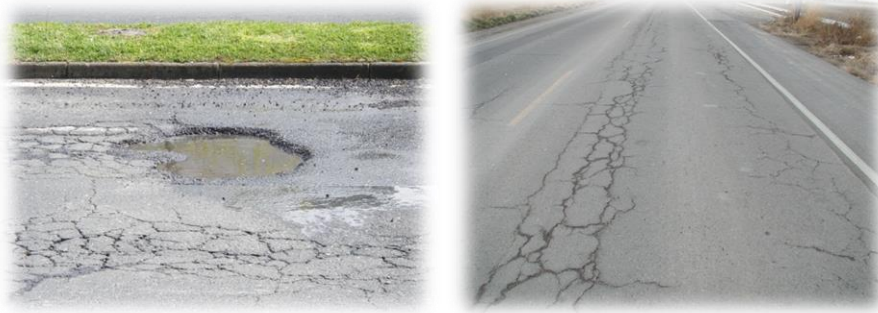
Figura 1.9. Baches y agrietamientos a temprana edad.
